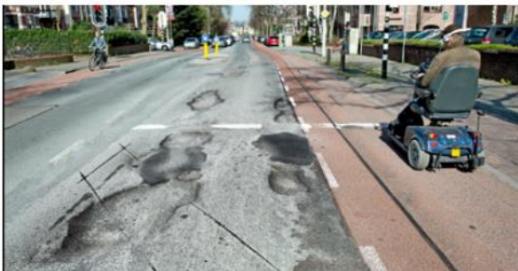
Grote gaten in het asfalt op een weg in Nijmegen. Het aantal zogenoemde wegbeheerschades is de afgelopen jaren met bijna 60% toegenomen.
